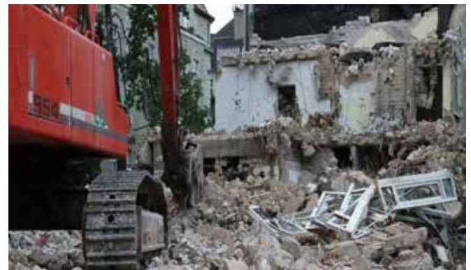
So bitte nicht mehr: Abriss ohne Materialrückgewinnung
